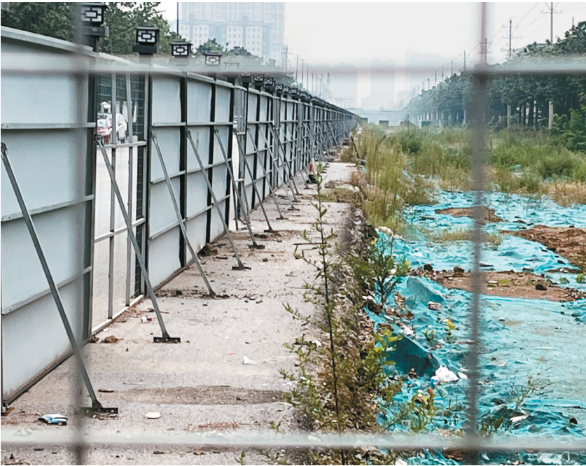
开挖的路基杂草丛生
